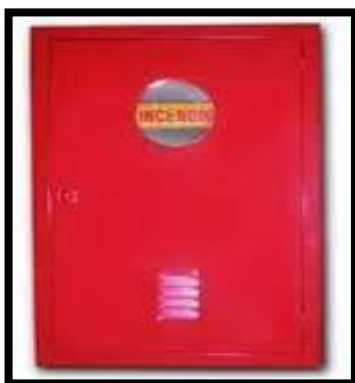
Figura 14 – Hidrante de Parede
